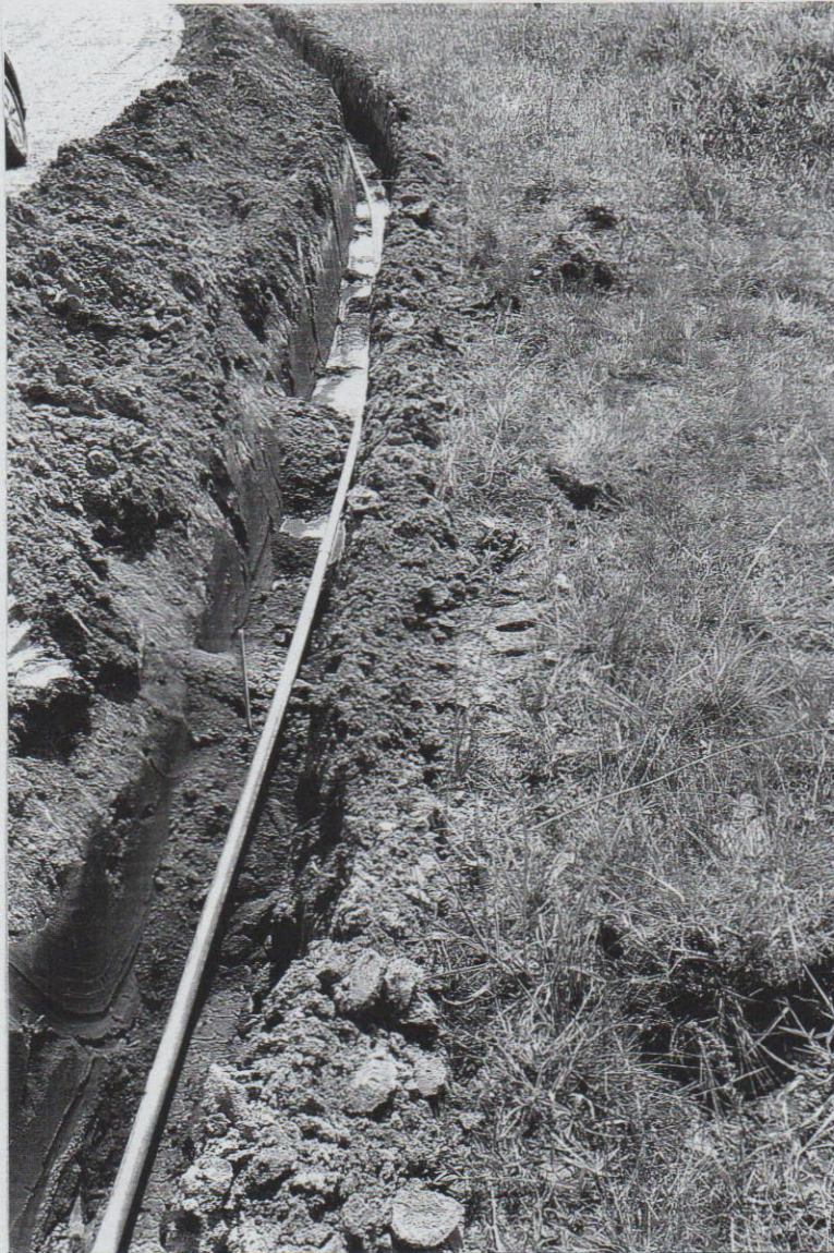
Detalhe do encanamento
