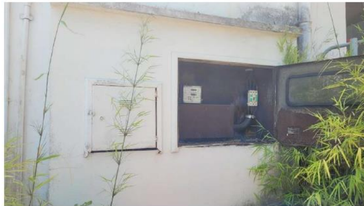
a) Quadro de medição
