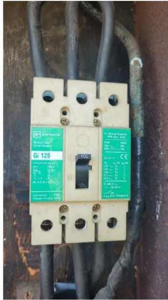
b) disjuntor geral
