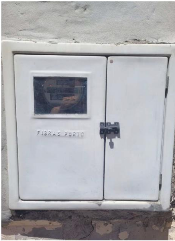
a) Quadro de Medição
