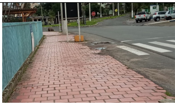
Foto 4: Passeio público, degradado e inadequado a legislação municipal.
