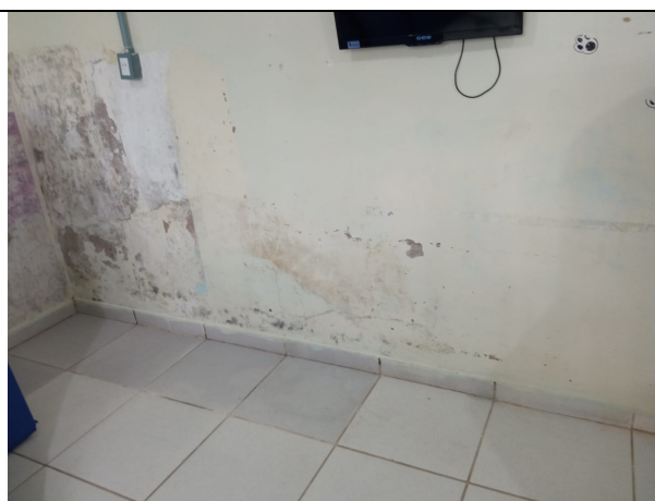
Foto 10: Parede interna do maternal, deteriorada pela infiltração advinda das instalações sanitárias da Foto 9.
