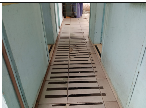
Foto 5: Acesso às salas de aula, com desníveis e pisos quebrados.
