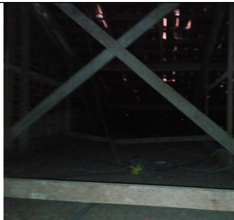
Foto 2: Madeiramento da cobertura, deteriorado e quebrado.
