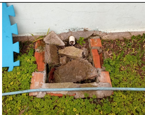
Foto 8: Caixa de inspeção dos sanitários do maternal, com tampa e tubulações quebradas.
