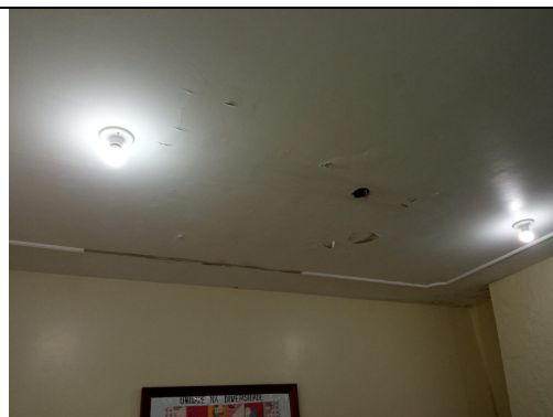
Foto 12: laje de cobertura do refeitório, com revestimento e pintura deteriorados.
