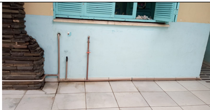
Foto 11: instalações sanitárias externas à cozinha, deterioradas.
