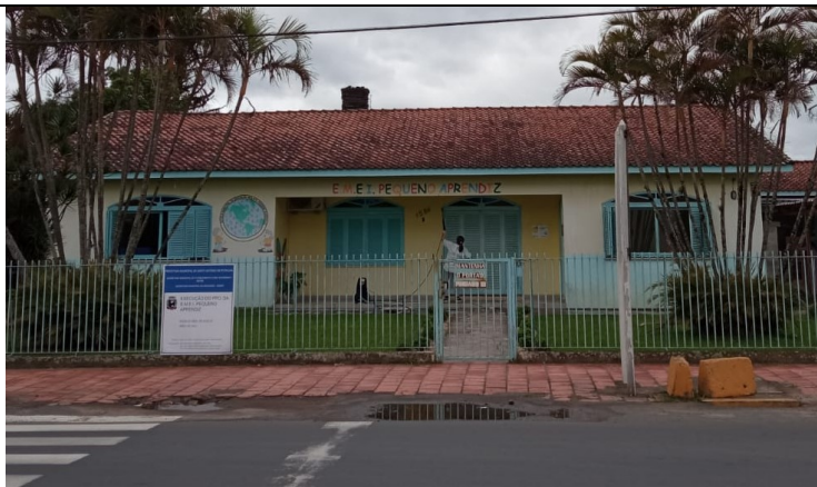
Foto 1: Fachada da escola: cobertura com abaloamento na cumeeira devido a deterioração do madeiramento. Na imagem, vê-se também os desníveis a serem vencidos com rampas de acessibilidade. Vê-se também a calçada deteriorada.
