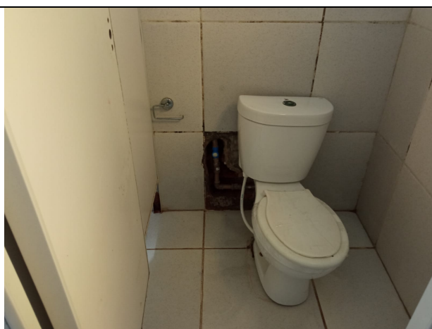
Foto 9: Sanitário do maternal, com avarias nas instalações hidráulicas e sanitárias. Vaso sanitário isolado pela equipe da Escola.
